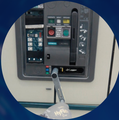
Mantenimiento realizado al interruptor siemens 3WL1116-4EB38-5FA4-Z en la subestación eléctrica de la empresa CyPlus Idesa. ABRIL DEL 2022
