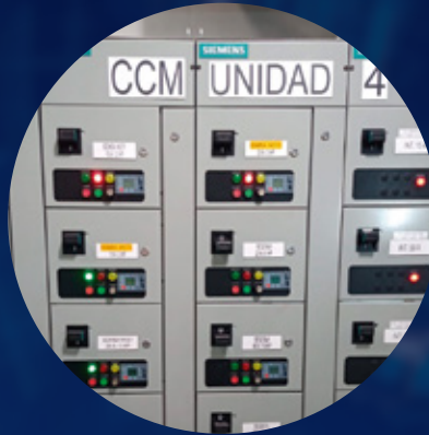
Preacomionamiento y comicionamiento de filtro de rechazo automatico a capacitores, filtro de activos de armonicos, y equipos de calidad de la energía.
