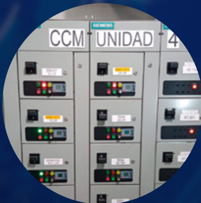
Diseño y fabricación de centro de control de motores para CFE GENERACIÓN VI U-1 Y U-3
